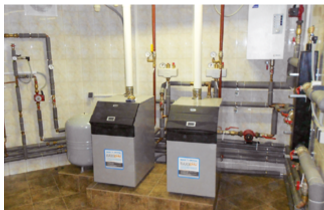
Жилой дом, г. Химки Общая мощность котельной — 200 кВт
